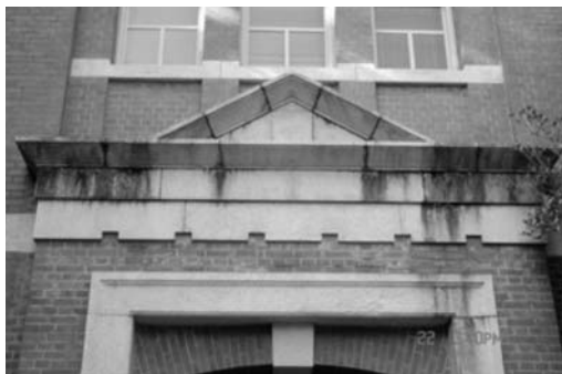
気生藻類による外壁汚れ
